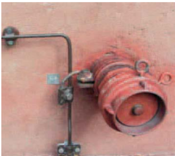
Rys. 3. Skorodowane połączenie części z różnych metali
